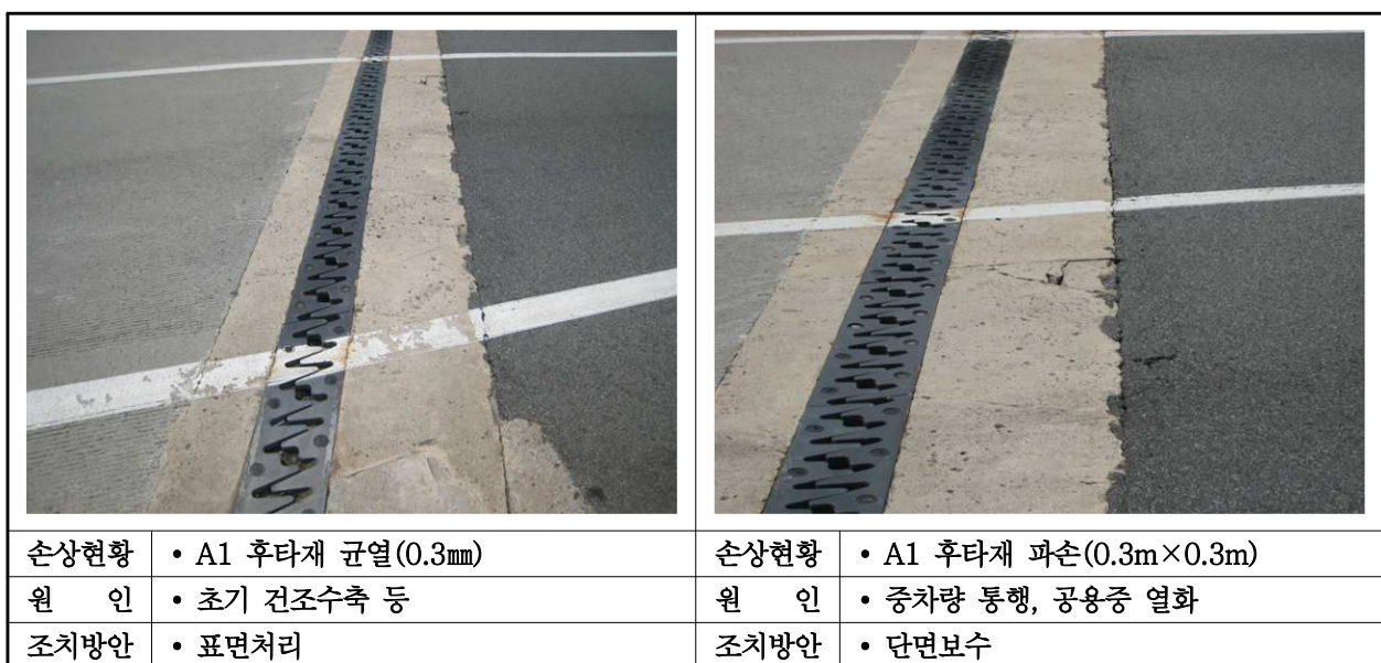
【사진 2.3.17】 신축이음장치 손상현황
